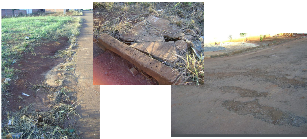
Figura 25: Floresta/ Asfalto, bocas-de-lobo e meio-fios danificados no Conjunto Cidade Alta, construídos em 2005 (2008)
