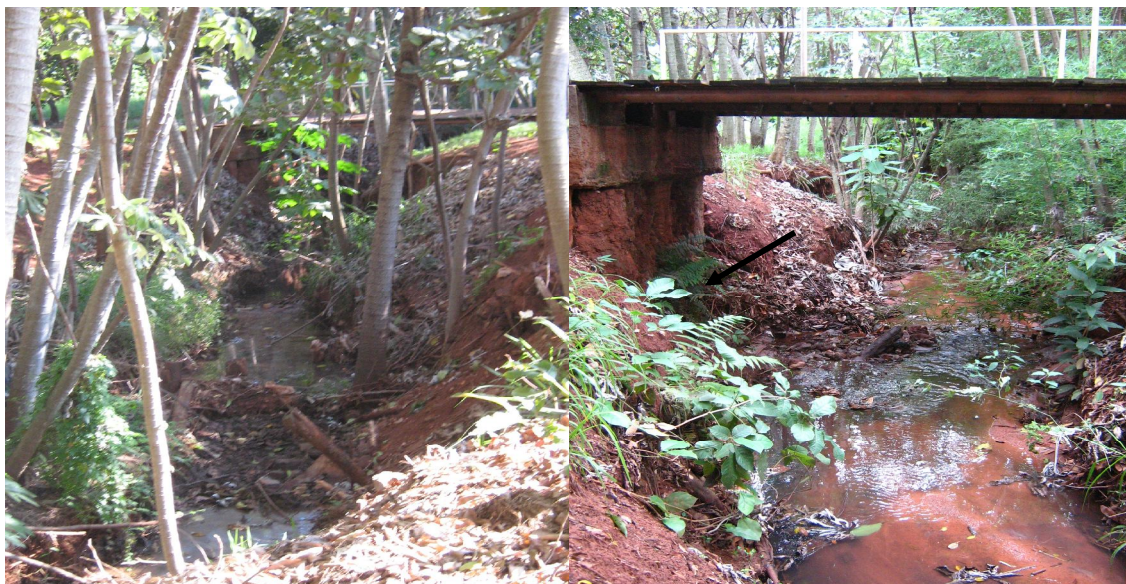
Figura 114: Áreas do córrego Água da Marilena com falta de manutenção.
