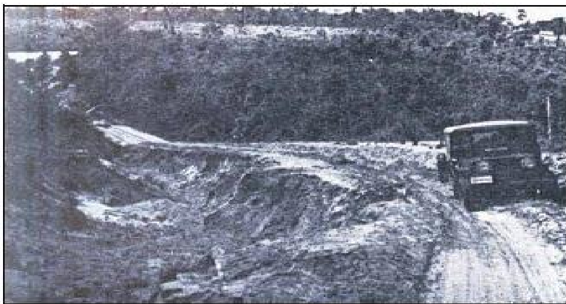
Figura 13: Estrada Principal Paranavaí a Maringá com processo erosivo em 1955?
