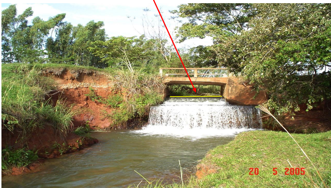
Figura 137: Cachoeira do Tranin - Ponte sobre o córrego Água da Marilena. Verifica que a construção da mesma e de uma barreira para formar a cachoeira (indicada pela linha amarela) dificultou o acesso por parte da areia assoreada e que vem sendo arrastada pelas águas do córrego. Parte desse material sedimentado está acumulando-se próximo a sua margem, acima da cachoeira (indicado pela seta vermelha e figura acima). Ao mesmo tempo a erosão vem expondo um perfil, mostrando as várias composições do solo neste local (evidenciado acima). Fonte: COSTA, S. B. (Maio/2005; Junho/2008).
