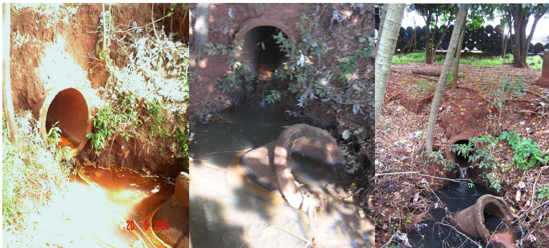
Figura 115: Galeria pluvial, em 2005, 2008 e 2009 nas proximidades do córrego.
