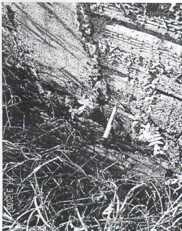
Foto 3 - Detalhe da Foto 4. Observa-se a presença do lençol freático aflorante junto ao muro. Nota-se também a presença de briófitas (musgos) e pteridófitas (samambaias).
