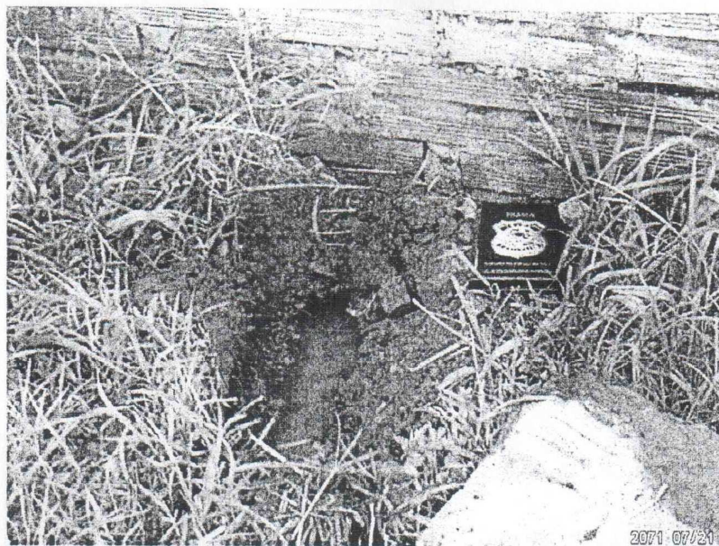
Foto 5 - Nível freático aflorando a 10 cm da Superfície no Ponto P-3.
