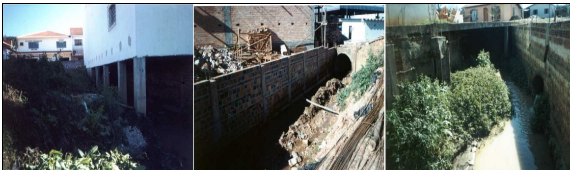
Figura 42: Construção sobre o leito, canalização feita de maneira aleatória, colunas e bancos de areia, representam alguns dos problemas relacionados à ocupação junto ao canal do rio Xaxim. Foto: Nelson Douhi – 2002
