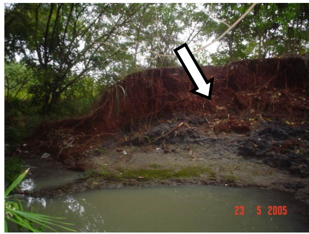
Figura 27. Degradação das margens da nascente do ribeirão Mandacarú - maio de 2005
