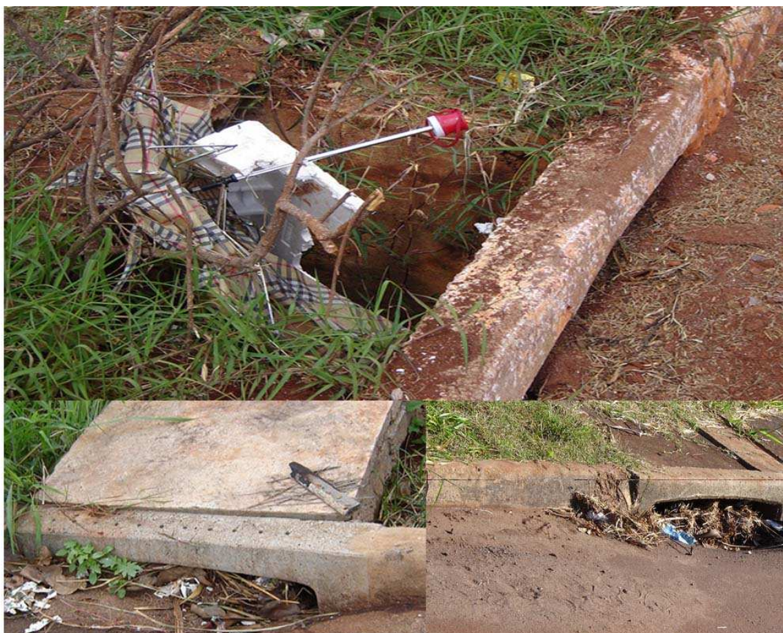
Foto 4.7 – Obstrução das galerias públicas de águas pluviais
