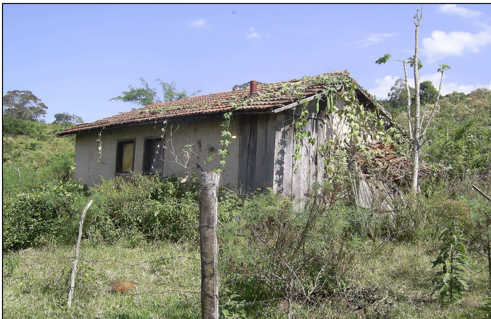
Foto 59 – O abandono da casa rural. Hoje serve de abrigo a aves e plantas que ousam enfeitar seus telhados
