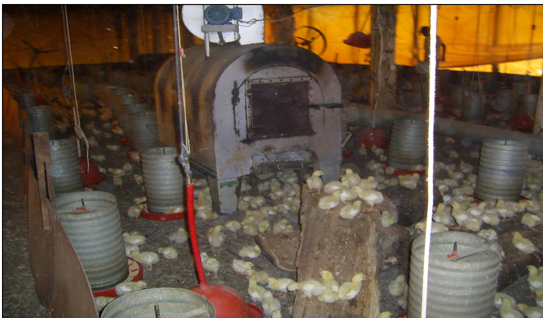
Foto 44 - Interior de um aviário com destaque para o forno à base de lenha Autora: DELGADO, E.N.F.
