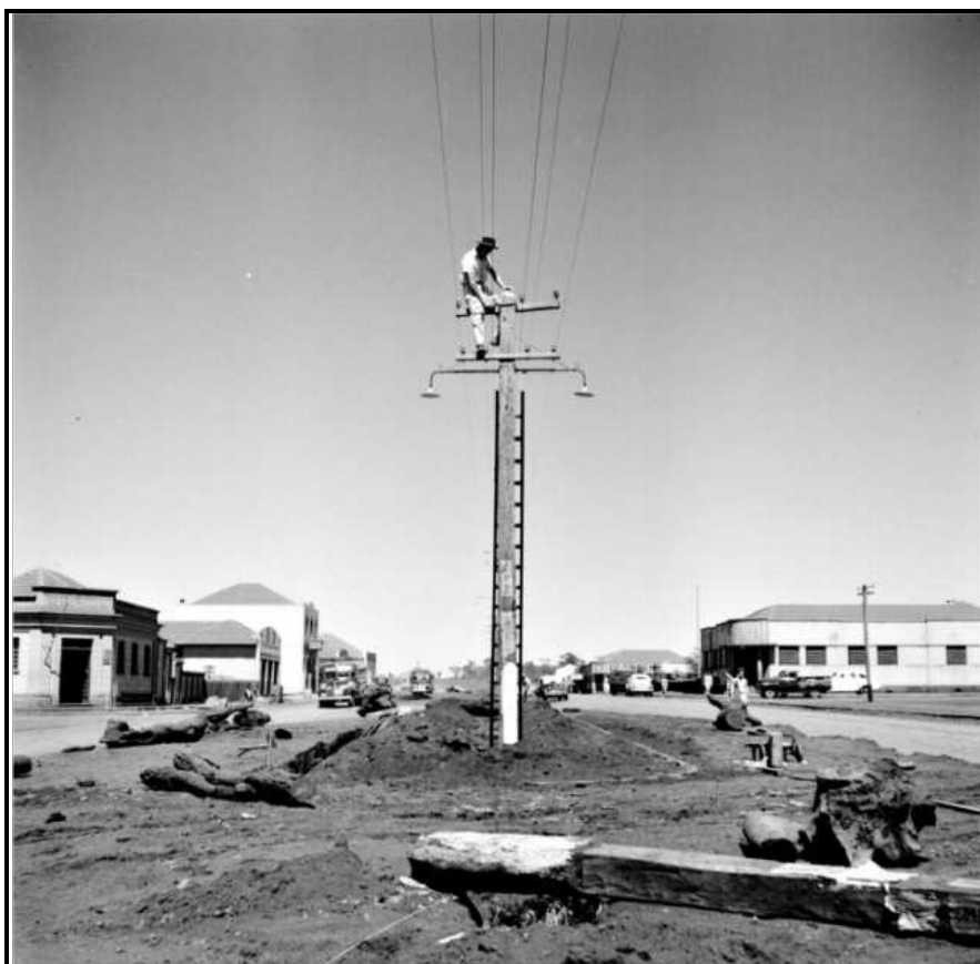
Figura 11: Instalação de energia elétrica na Avenida Brasil. Sem datação. Fonte: Museu da Bacia do Paraná – UEM.
