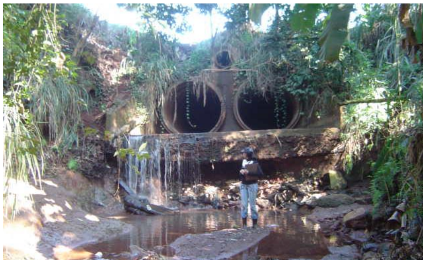
Figura 16: Erosão do canal e da base da estrutura da tubulação a jusante da passagem das ruas e avenidas – autor Baggio J.M.
