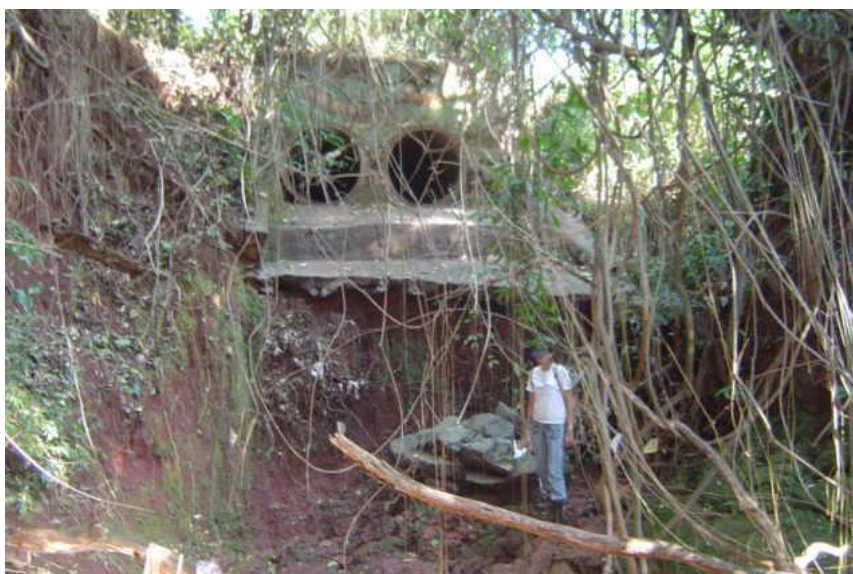
Figura 13: Dissipadores destruídos – córrego Cleópatra e córrego Borba Gato – autor Baggio J.M.
