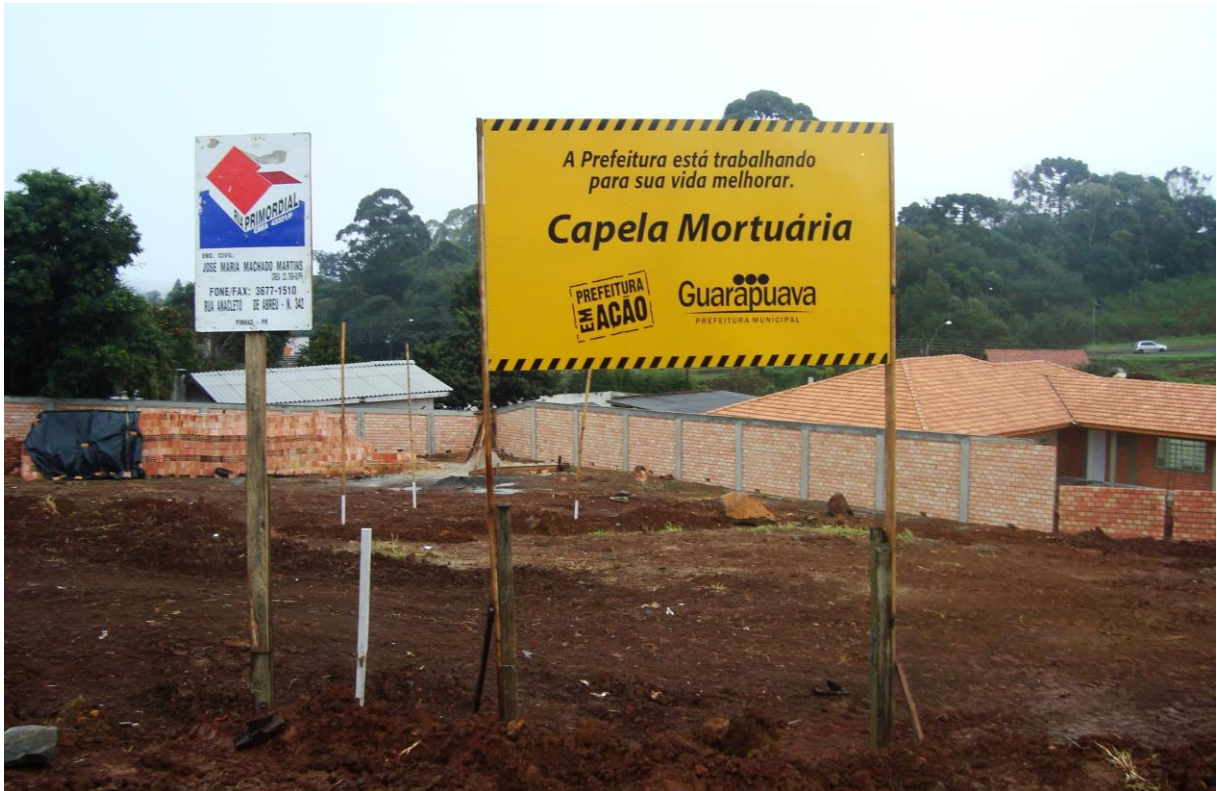
Foto 5: Obra da Capela Mortuária da Vila Pequena. Local: Guarapuava: Rua Pedro Alves, bairro Batel. Foto: Fachin, Simone C, 2012
