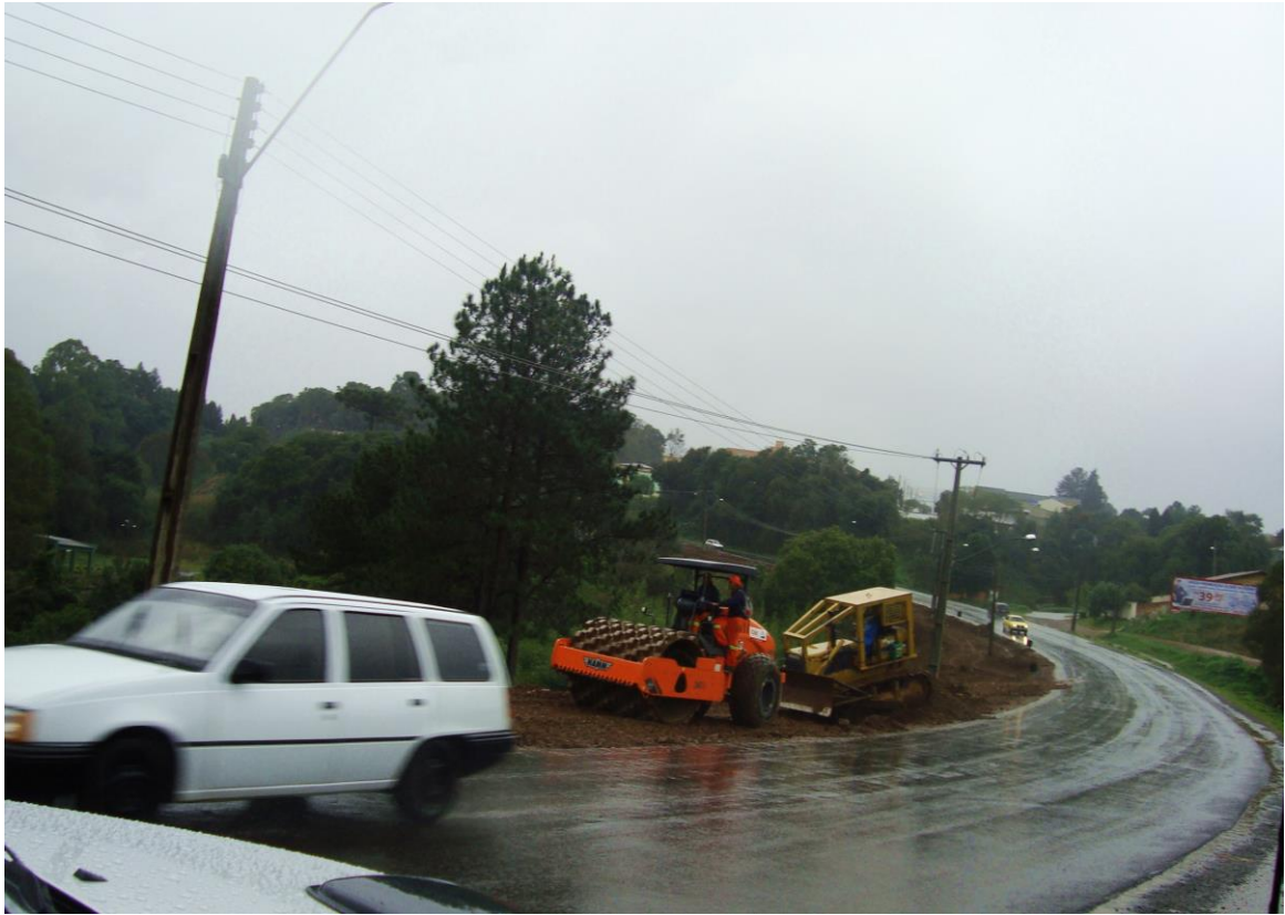
Foto 8: Obra de ciclovia e pavimentação. Local: Guarapuava: Avenida Governador Serafim Ribas Foto: Fachin, Simone C, 2012.
