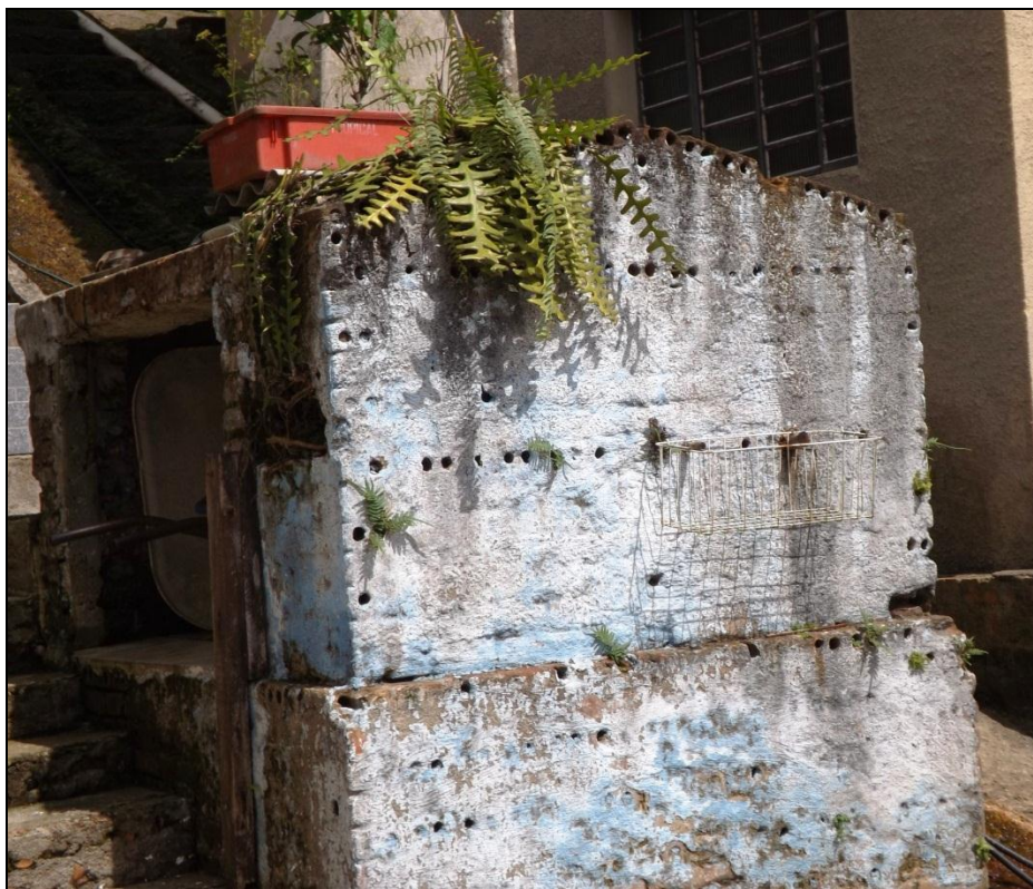
Figura 30. Fonte mencionada na obra de Alvar hoje um depósito particular e lixeira. SOUZA. R.M. (jan. 2013).
