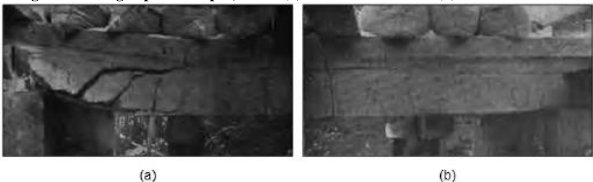
Figura 2.3 - Viga após o colapso, sendo (a) lado sem estribos e (b) lado com estribos
