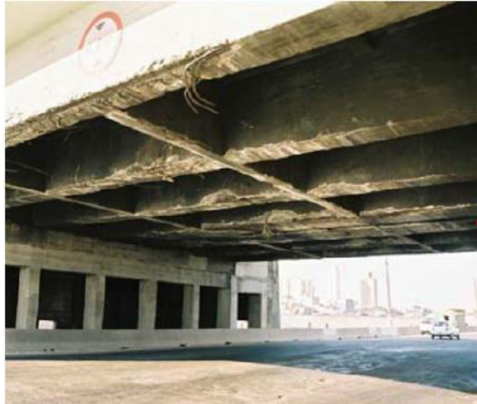
Figura 1.2 - Ponte do Limão (SP) com armadura exposta
