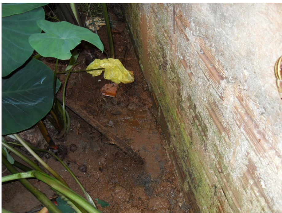
FIGURA 17: PRESENÇA DE UMIDADE NA PARTE EXTERNA DO MURO DE UMA RESIDENCIA NA RUA PION. FUMIE TANQUE NO RESIDENCIAL TARUMA
