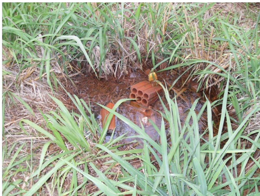
FIGURA 16: SURGENCIA DO LENCOL FREÁTICO NA RUA PION. FUMIE TANQUE NO RESIDENCIAL TARUMA
