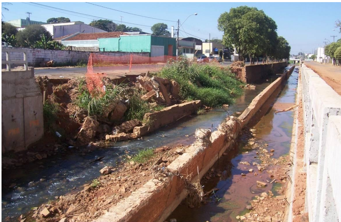
Figura 72: Córrego do Biriguizinho, Birigui/SP – Desmoronamento das margens e obras para contenção de enchentes.
