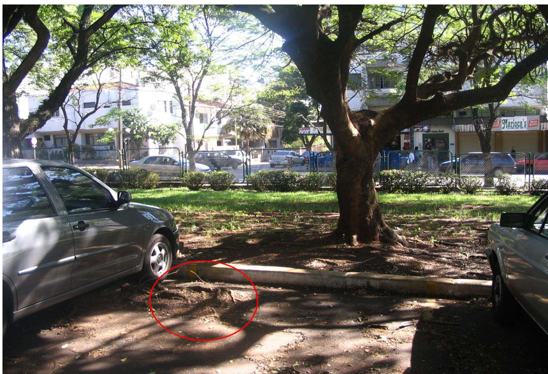
Foto 22 – Afloramento de raiz e danos no asfalto, provocados por flamboyant ( Delonix regia ), localizado na lateral oeste da via asfáltica, em frente ao bloco 2.
