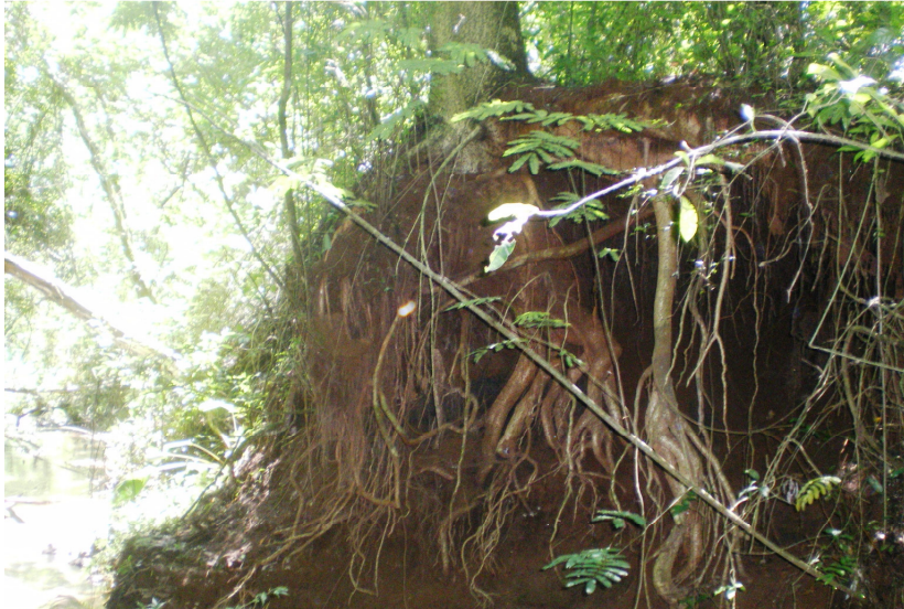
Figura 66: Erosão em Margem de córrego no fragmento 89 Foto: André C. F. Sampaio Jan/2013
