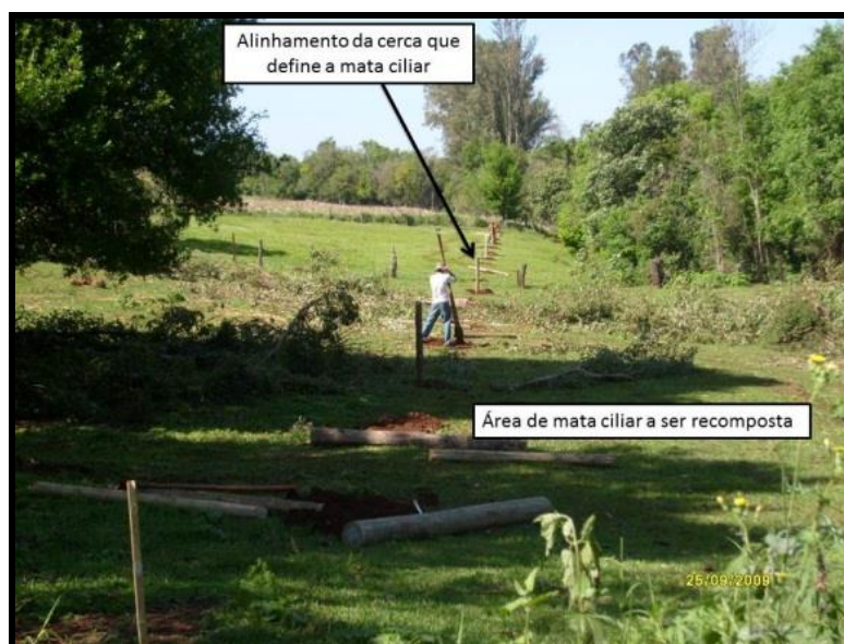
Fonte: Secretária Municipal de Agricultura. Diretoria de Meio Ambiente. Foto 17 – Alinhamento, escavação e fixação dos mourões na sub-bacia Flor do Sertão
