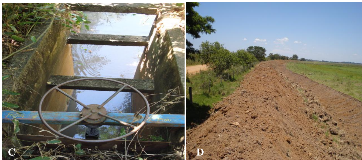
Figura 33: Sistemas artificiais de controle de inundações na planície de inundação do rio Ivaí.
