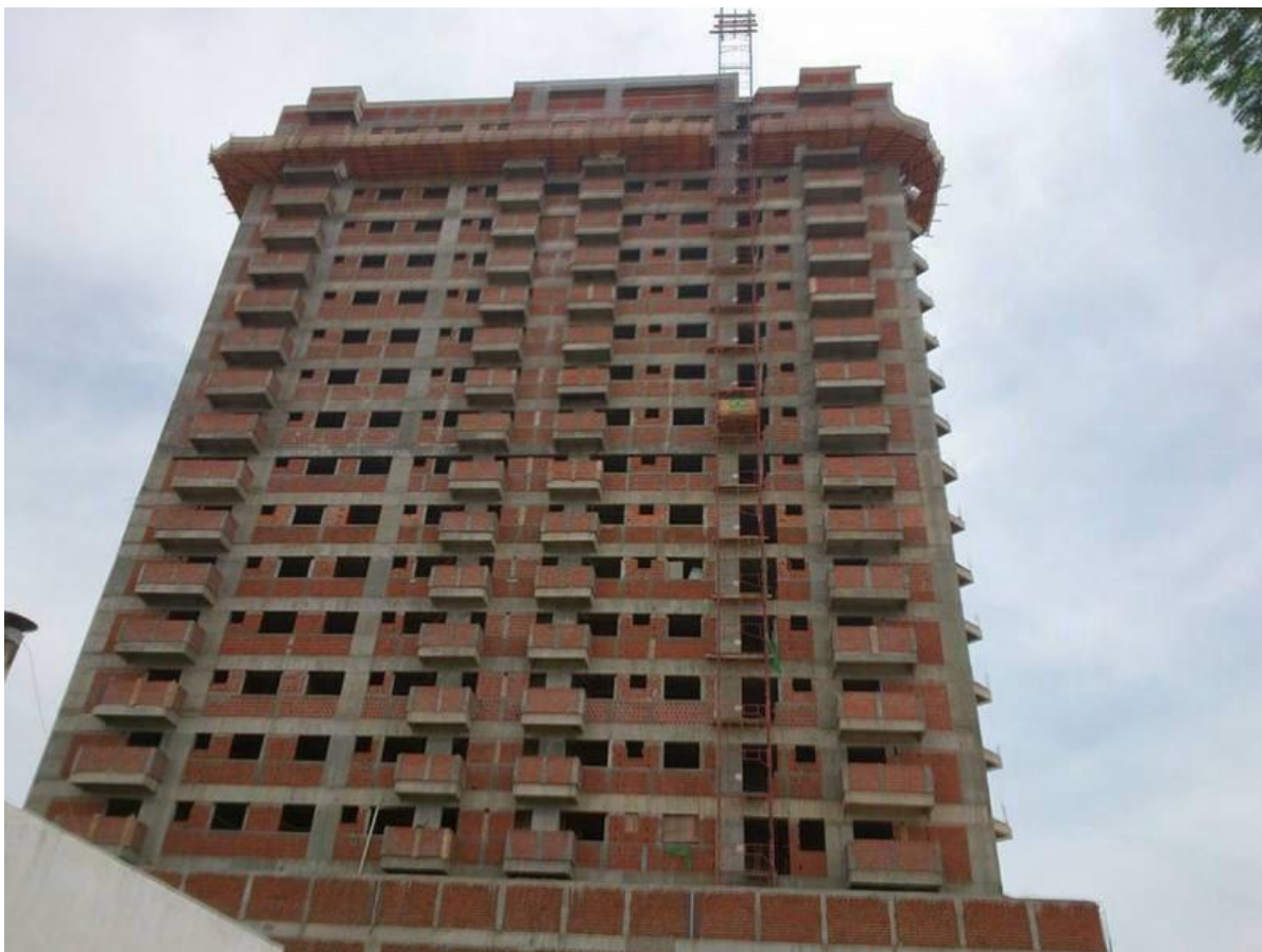
Figura 14: Vista parcial do Edifício Victoria Garden, em construção- Paranavaí- PR, 2014. (dois apartamentos por andar – área privada 164m 2 – estimativa de preço final na entrega R$1.000.000,00) Fonte: ENGEPEC, 2014.
